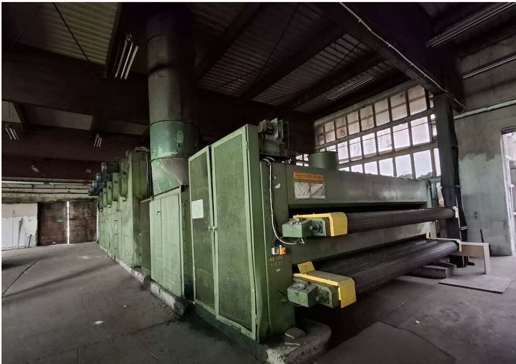
Stan obecny - urządzenie w zabudowie zakładu
