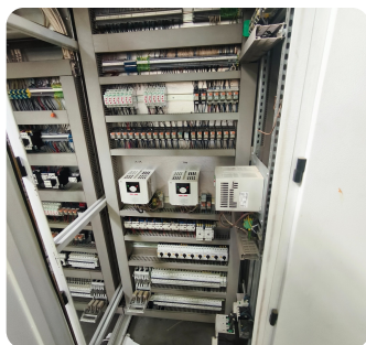
Electrical cabinets / Szafy sterownicze
